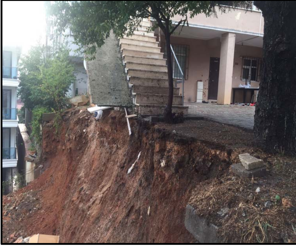
Fotoğraf 3: Duvarın Yıkılması Sonrası Askıda Kalan Merdivenler ve Bina Temeli.
