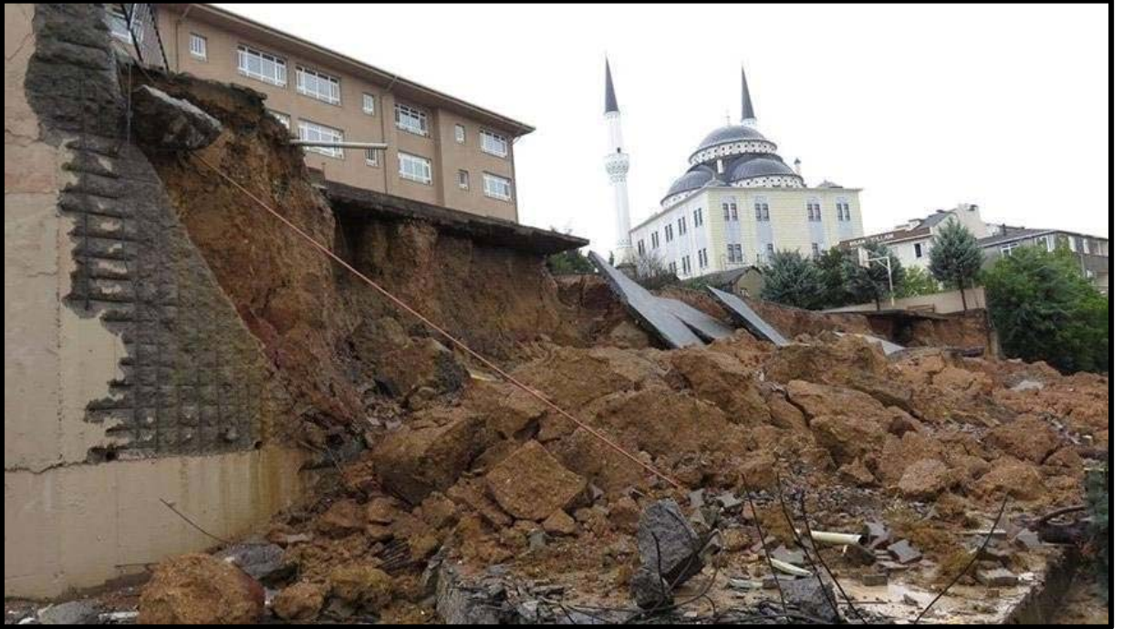
Fotoğraf 7: Yıkılan Bahçe Duvarı ve Mandıra Caddesine Akan Niteliksiz Dolgu Malzemesi.
