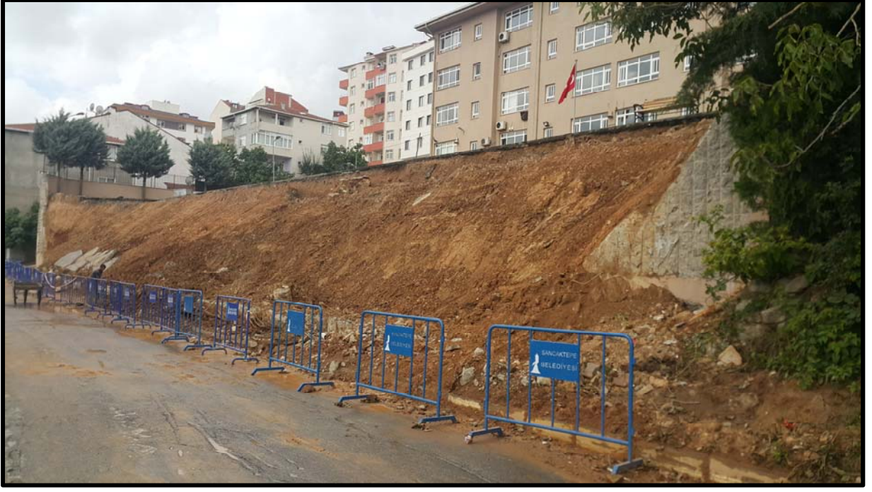
Fotoğraf 8: Yıkılan Bahçe Duvarı Arkasında Yıkılma Sonrası Temizlenmiş Dolgu Yüzeyi. Dolgu Malzemesi Niteliksiz Malzemeden Oluşmaktadır.
