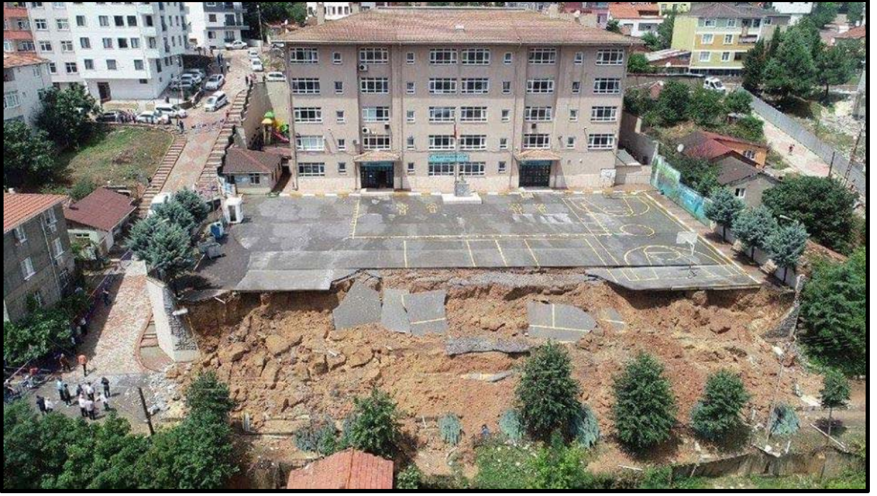
Fotoğraf 6: Yıkılan Okul Bahçe Duvarı ve Akan Dolgu Malzemesine Dođudan Bakış.
