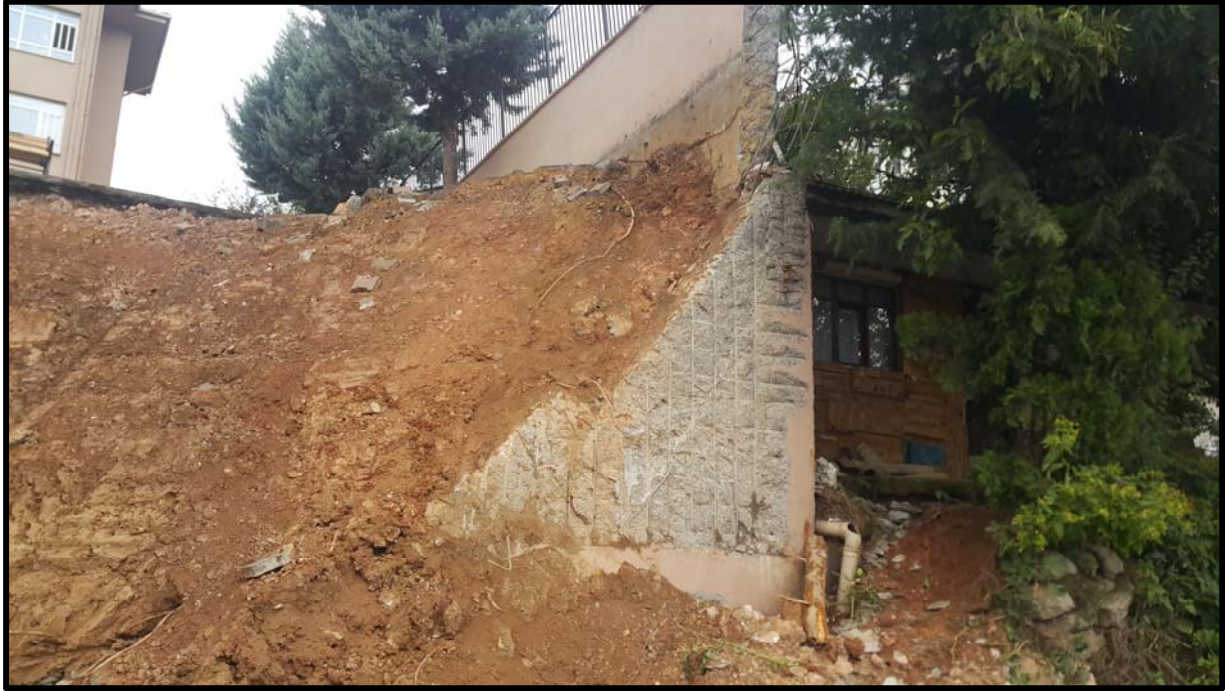
Fotoğraf 11: Dolguyu Çevreleyen İstinat Özelliği Taşımayan İnce Perde Duvar.
