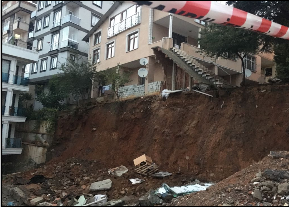
Fotoğraf 2: Duvarın Yıkılması Sonrası Şev Yüzeyi ve Riskli Binanın Görünümü.
