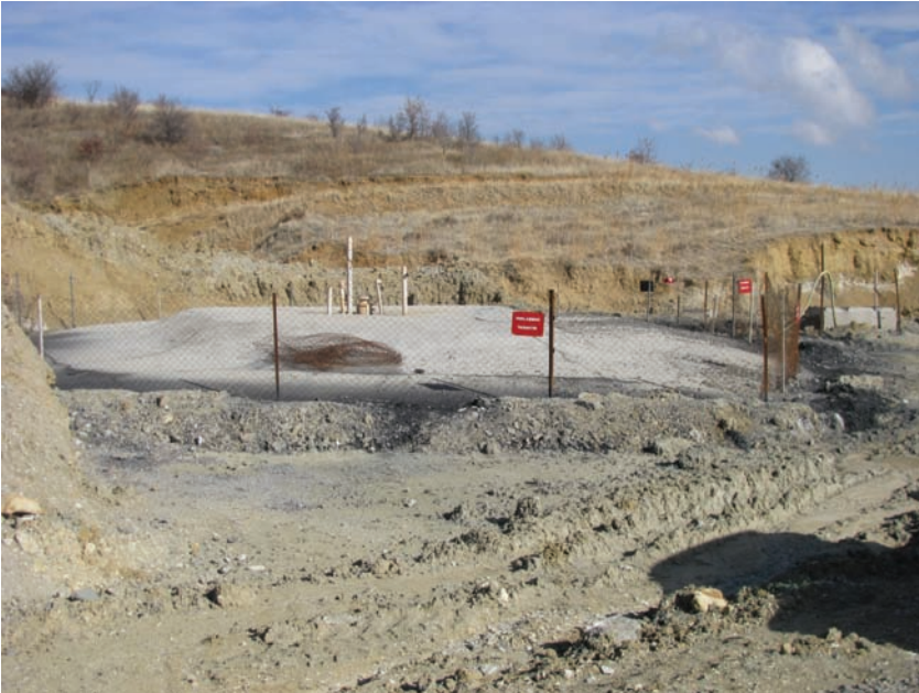
Foto.10. Isparta Yakaören köyü civarından kontrolsüz üretim yapan jeotermal kuyu başına görünüş itibari ile büyük bir beton dökme ile kontrol sağlandığı zannedilmektedir.
