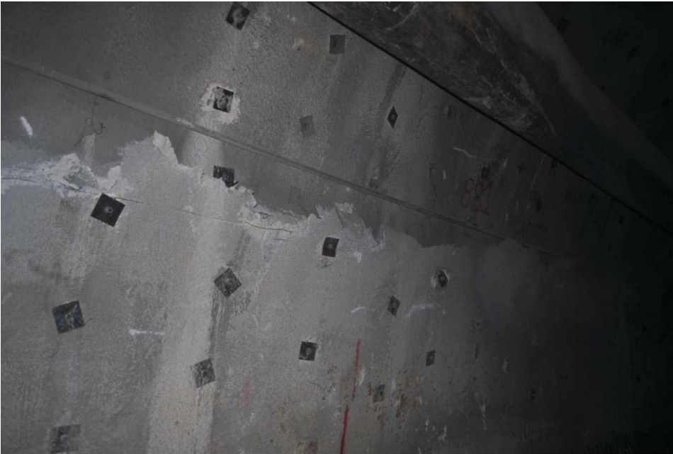
Őekil 8. Alt yarı ve üst yarı birleşimindeki püskürtme beton birleşim bölgesinde meydana gelen çatlaklar.
