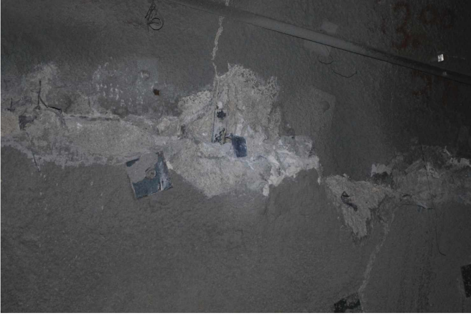
Őekil 7. Püskürtme betonda meydana gelen çatlaklar.
