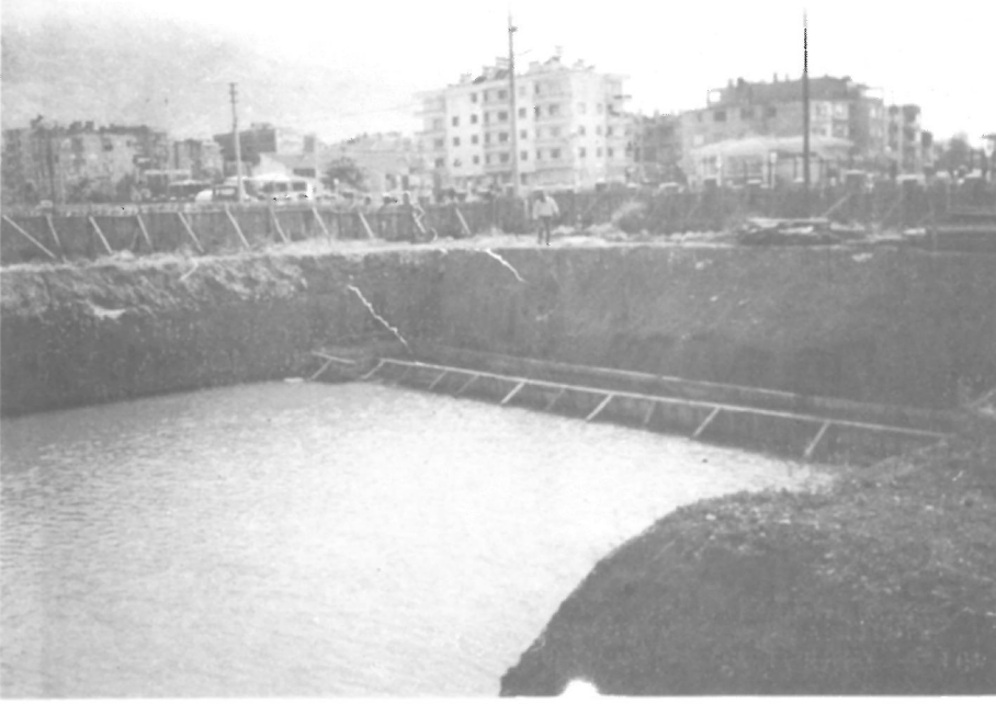
A- 2 Mart 1992 - Manisa Öğretmenevi. Zemin islahı öncesi, islah yapılmadan temel atma çabası başarısızlıkla sonuçlandı. Kireçtaşı stabilizasyonu ile zemin kurutuldu.
