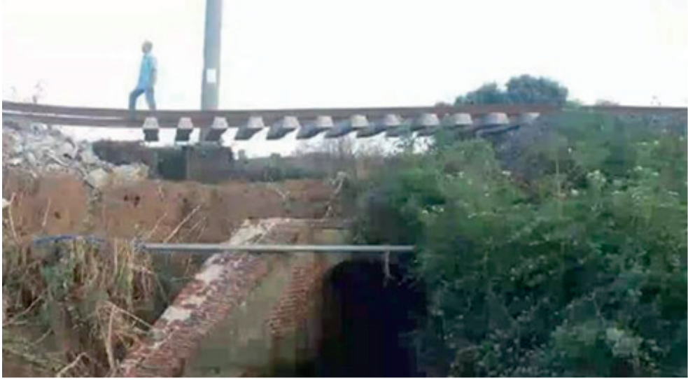
Şekil. 7: Rayların altındaki dolgunun boşalması sonrası ortaya çıkan görüntü
