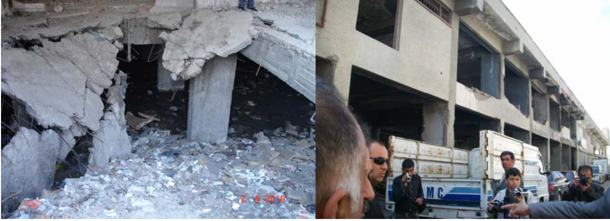
Resim 21. Batman Toptancılar Sitesindeki Patlama İzleri
