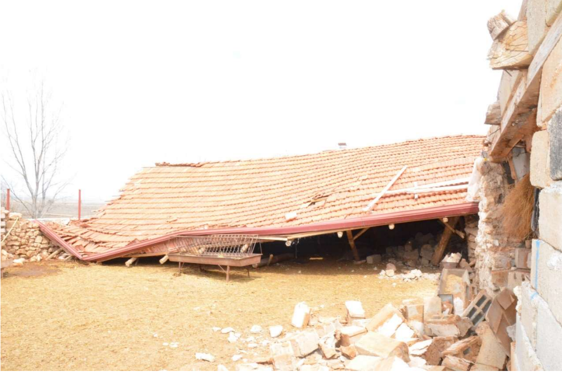
Şekil 12. Yeniköy mahallesinde yıkılmış ahır yapısı.
