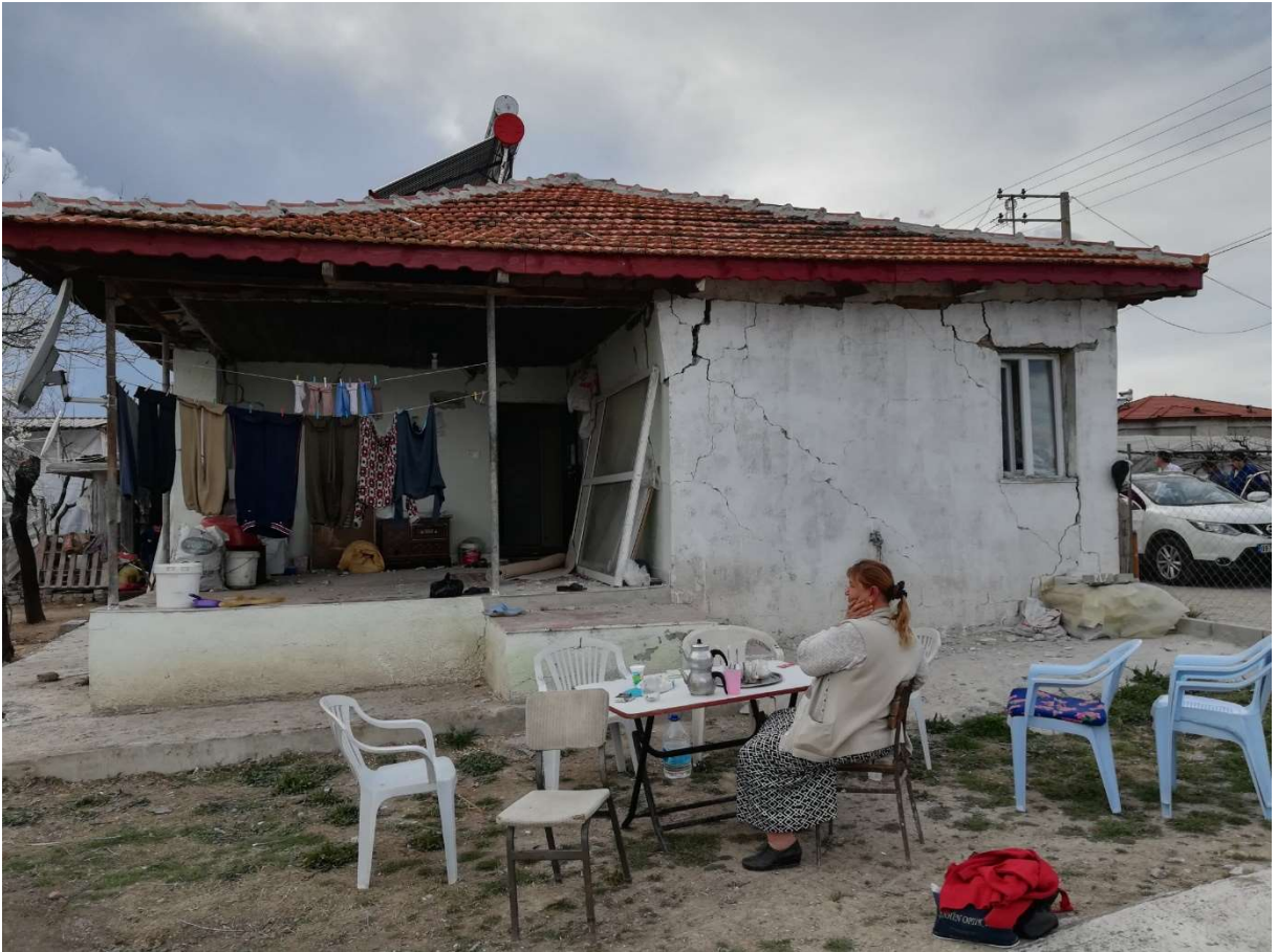
Şekil 20. Apa mahallesinde ağır hasarlı tek katlı yığma yapı.
