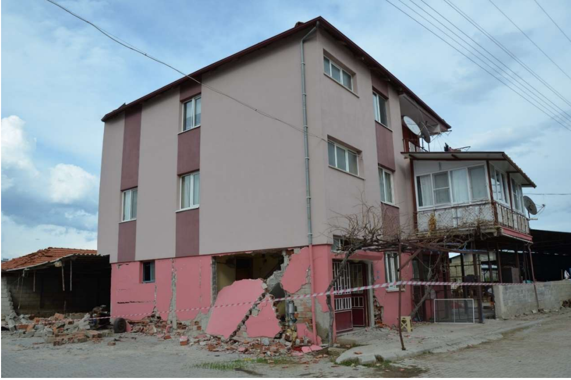
Şekil 17. Karahüyük mahallesinde zemin katının dolgu duvarları kırılmış betonarme yapı.
