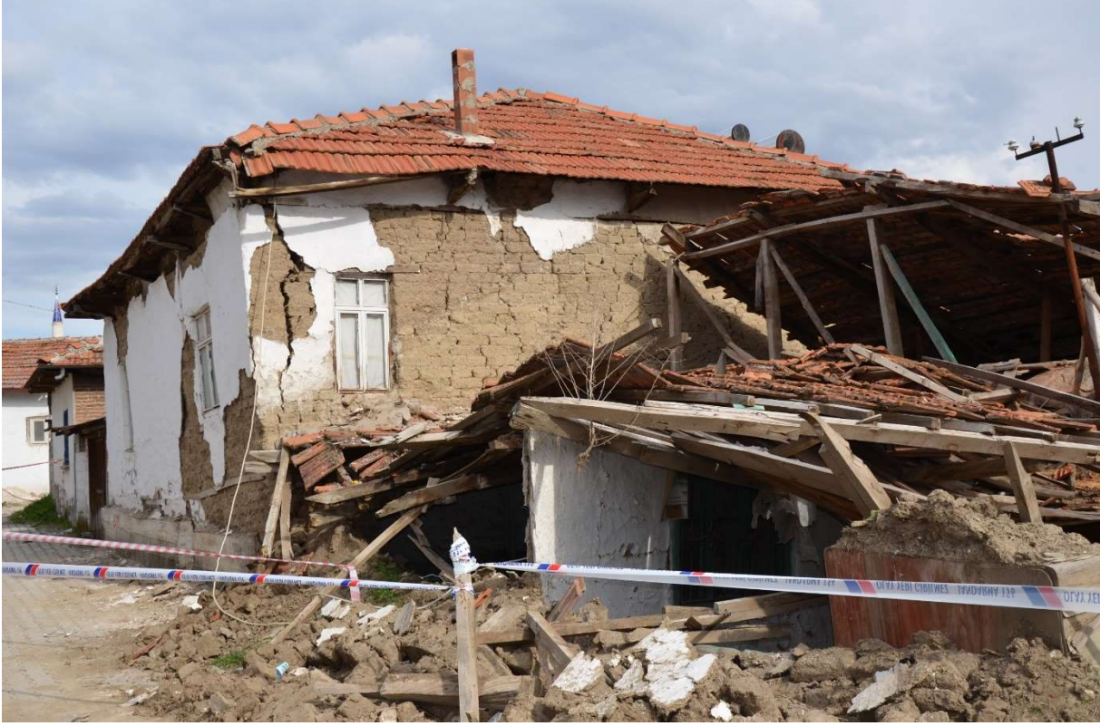
Şekil 16. Karahüyük mahallesinde yıkılmış ve ağır hasarlı kerpiç yığma binalar.
