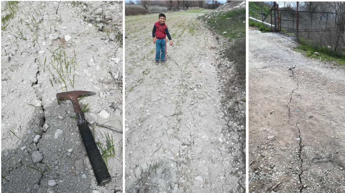
Şekil 5. Yeniköy mahallesinin güneyinde gözlenen yüzey çatlaklarının görünümü.
