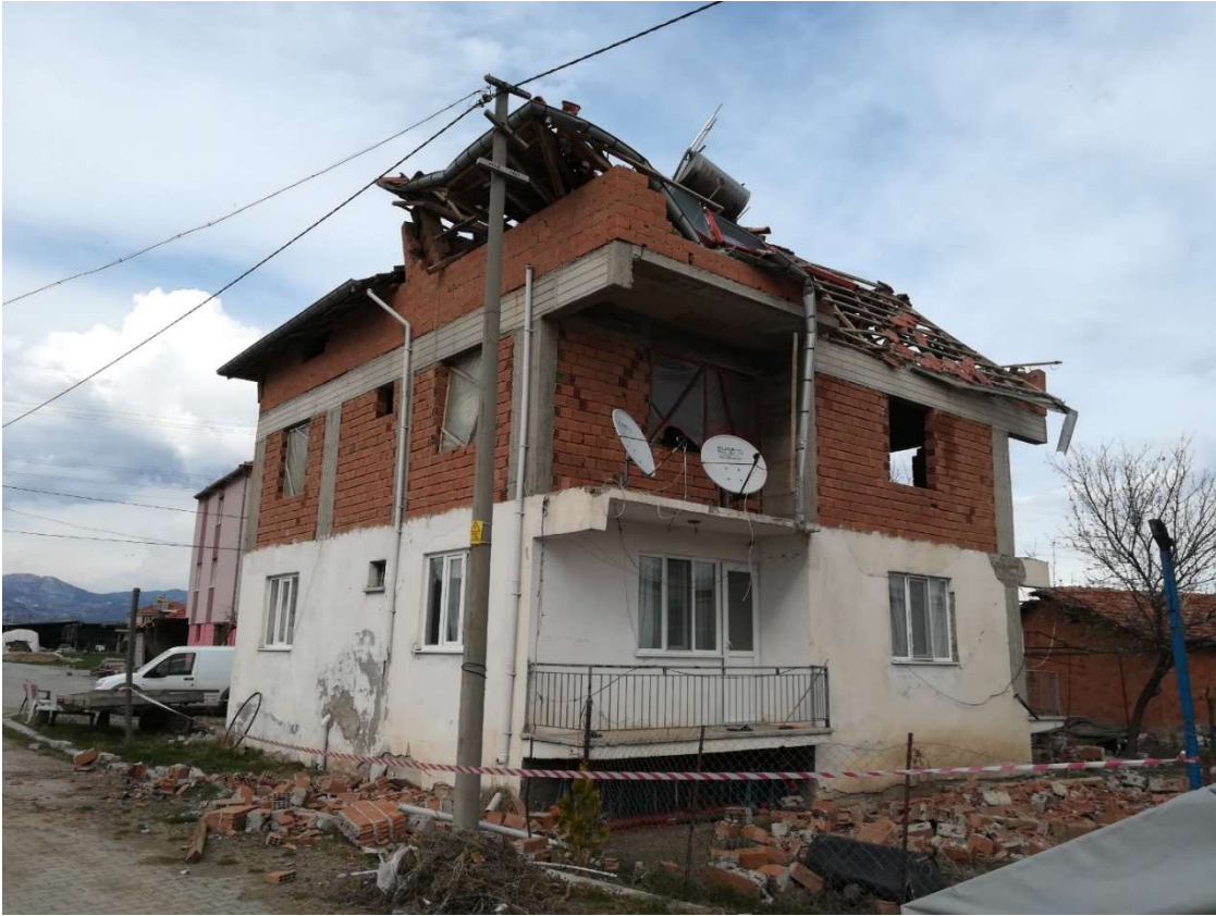
Şekil 18. Karahüyük mahallesinde yığma tuğla üzerine yapılan çatı katının yıkılmış görünümü.
