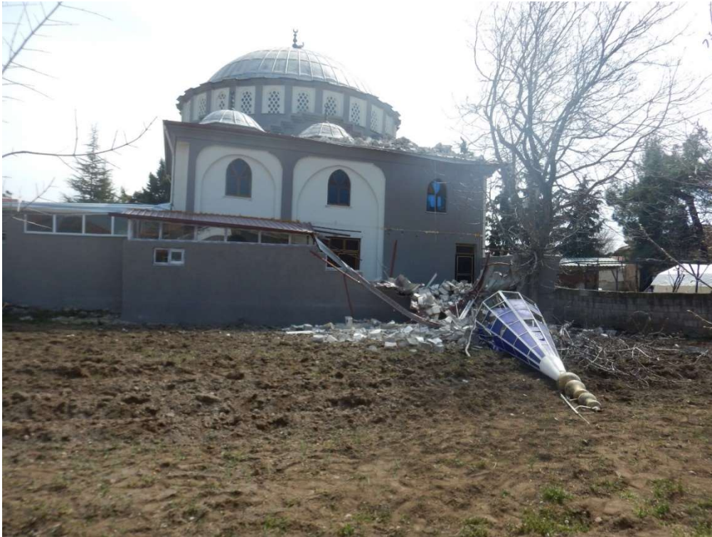
Şekil 24. Oğuz mahallesi camisinin minaresinin K30B'ya devrilmiş görünümü
