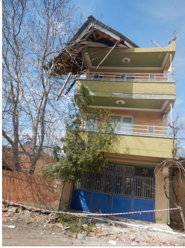
Şekil 23. Oğuz mahallesinde çatı katı yıkılmış betonarme yapı.
