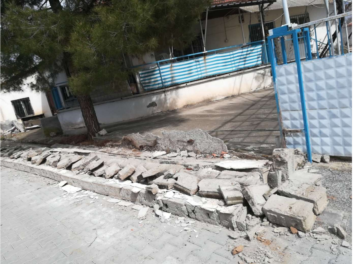
Şekil 13. Yeniköy mahallesinde devrilmiş bahçe duvarı.
