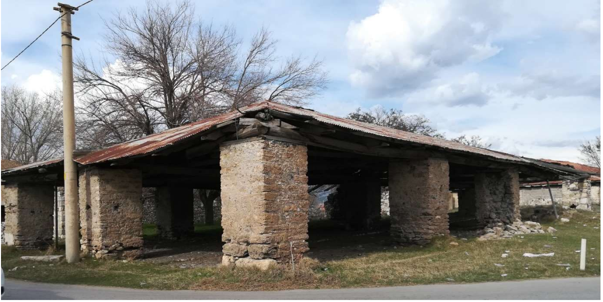
Şekil 19. Karahüyük mahallesinde Selçuklu döneminden kalan tarihi pazaryeri yapısındaki hasarlar.
