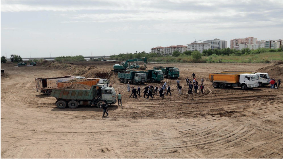
Şekil 40. Antalya Boğaçay Projesi start aldı, Antalya Büyükşehir Belediyesi'nin kanal projesi Boğaçayı'nda çalışmalar başladı. Kaynak: Antalya Boğaçayı Projesi Start Aldı (www.konyaninsesi.com.tr 13 Nisan 2018)
