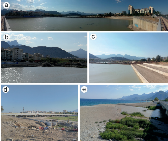
Şekil 53. Boğaçay proesi 1. Etap çalışmaları (10 Ağustos 2018), a: Kazı sonucu oluşan göle Akdeniz Bulvarı Boğaçay köprüsünden panoramik bakış, b: Aynı yerden sağ sahil imalata, c: Sol sahil imalata (basamaklı sedde), d: Sol sahilde, içmesuyu kuyularına 200 m mesafeden Boğaçay köprüsüne bakış, e: O tarihte henüz kazma vurulmamış Konyaaltı plajı ve Boğaçay'ın görünümü (Foto Tahir Avcı)
