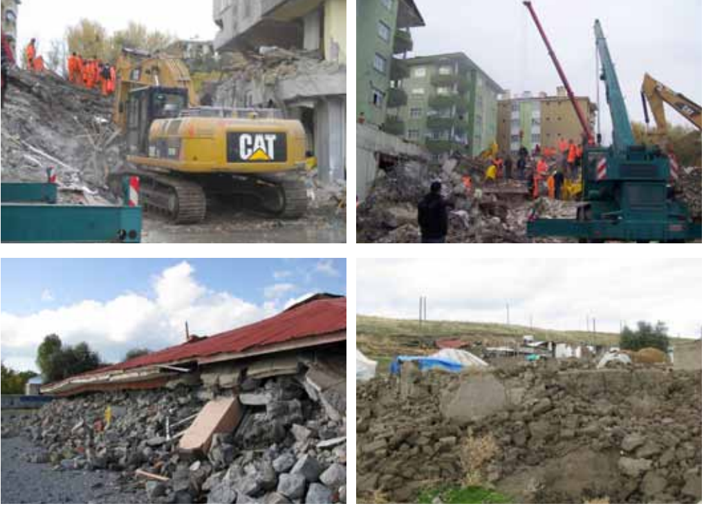
Şekil 36. Erciş'te enkaz kaldırma çalışması (sol üste), Erciş'te arama kurtarma çalışmaları (sağ üst), yıkılan Alaköy İlköğretim Okulu laboratuvar binası (sol alt), Dibekdüzü köyünde kaldırılmamış enkazlar (sağ alt).
