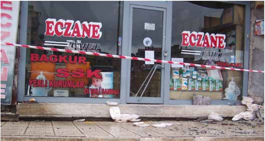
Şekil 15. Erciş ilçesindeki zeminde gözlenen oturma yapıları nedeniyle binalarda gelişen hasarlar. Yerdeki oturma nedeniyle kaldırım ile bina temeli arasında 5 cm'lik bir kot farkı oluşmuştur.
