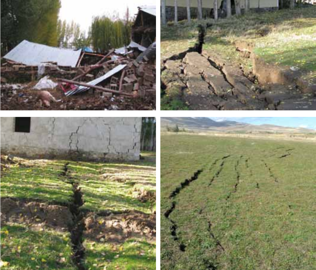
Şekil 31. Erciş-Çelebibağ beldesinde yıkılan hayvan barınağı (sol üstte), yanal yayılmanın yapı üzerinde neden olduğu hasar ve deformasyon (sağ üst ve sol alt), deprem sonucunda oluşan yanal yayılma ve heyelanları (sağ alt) gösteren arazi görüntüleri.
